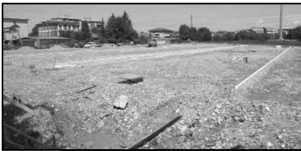
Il cantiere per il nuovo parcheggio da 270 posti auto vicino al cimitero (foto Cesni)
